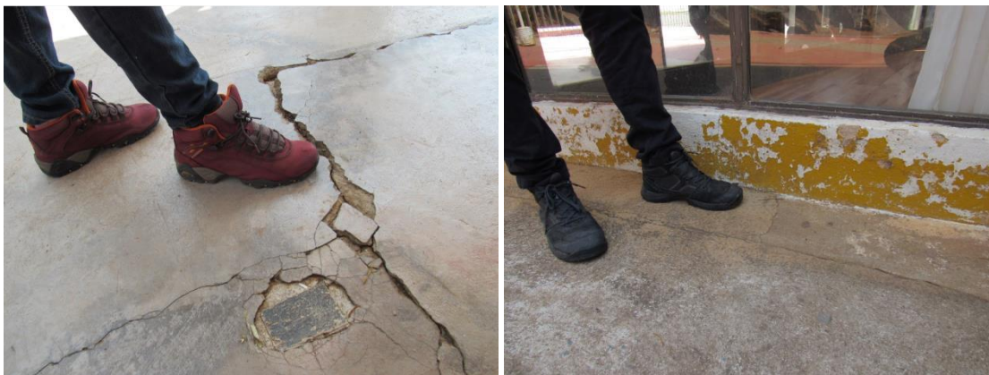
Conjunto de imagens 3 - Fissuras nos pisos - Fonte: IEF/MG
