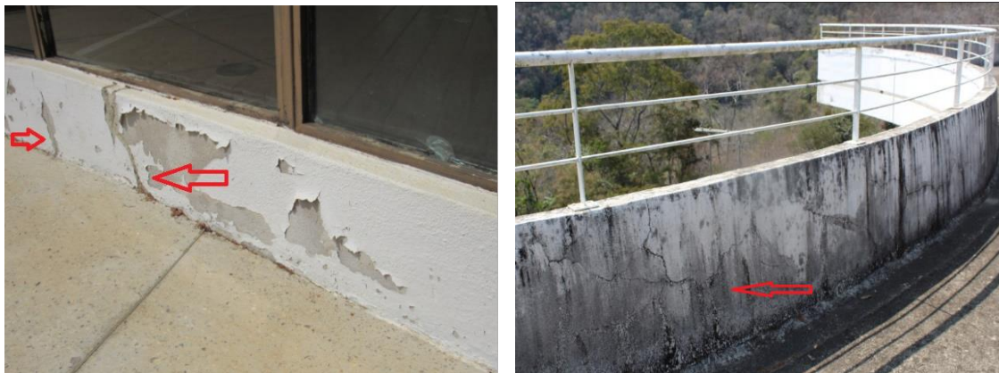
Conjunto de imagens 2 - Fissuras nos revestimentos - Fonte: IEF/MG
