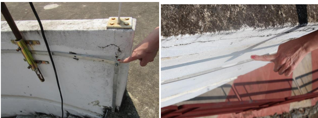
Conjunto de imagens 8 - SPDA e instalações cobertura Museu - Fonte: IEF/MG
